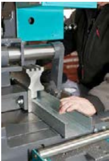
Die Elemente werden auf die richtige Länge zugesägt. | Les éléments sont sciés à la bonne longueur.
